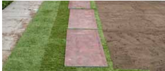
Verlegung des Fertigrasens im Verbund auf angefeuchtetes Planum, ohne dieses zu betreten
